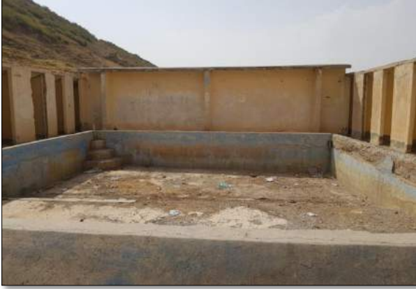
Şekil 7: Kullanım Dışı Bırakılan Kaplıca Binası
