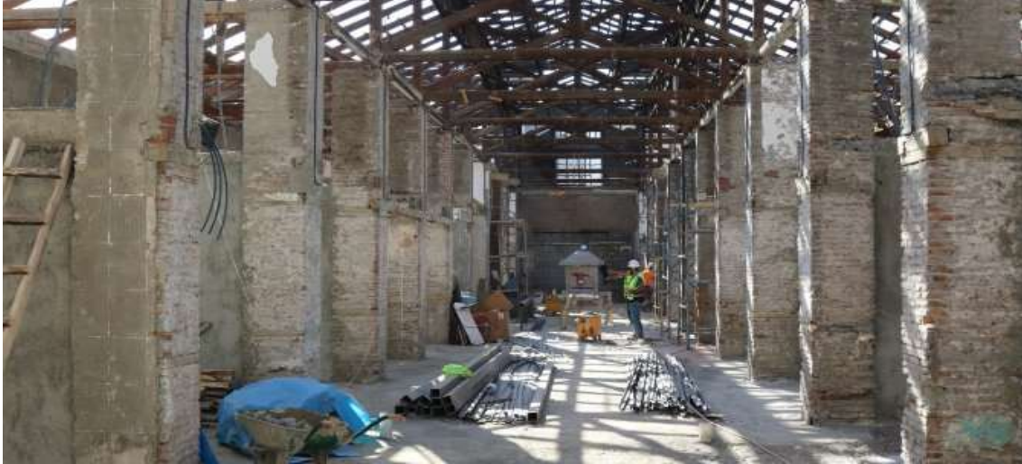
Fotoğraf 3.3. Peynirciler Çarşısında Ana Bina Restorasyon Çalışmalarından Bir Görüntü. (Kaynak: Tarihi Peynirciler Çarşısında Restorasyon Sürüyor: 2018)
